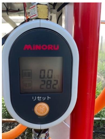
流量計で使用量を計測
