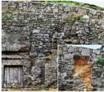
崩落した世之主の墓の石積み
