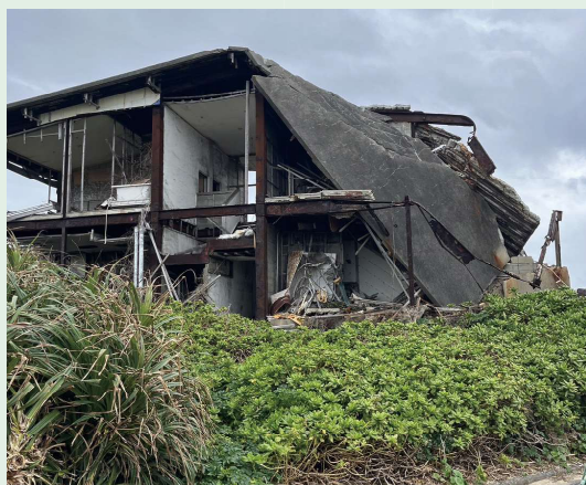
▲国頭字海岸線沿いの廃屋
