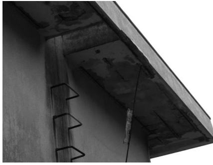
コンクリートの腐食が進む喜美留住宅団地
